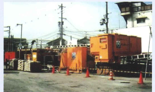
地上部プラント
