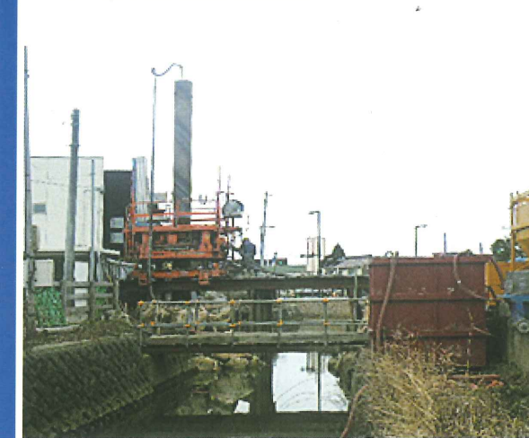
都市計画道路軽海線街路工事 石川県 鋼管杭φ600mm, L=29.5m, 4本, 3本継
