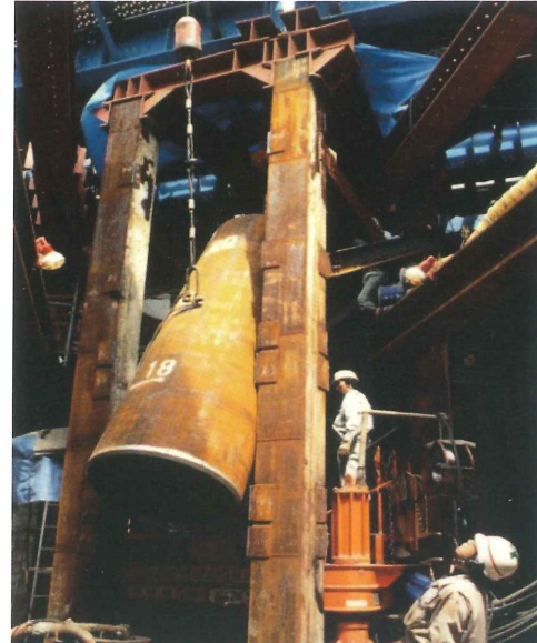
横浜市委託：金沢文庫駅～ 神奈川県 ～金沢八景駅間宮川橋梁架替工事 鋼管杭φ1200mm, L=31.2m, 90本, 9本継
